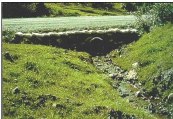
Figure 3.11 Les ponceaux de drainage transversal et les fossés de décharge transportent l'eau de la route vers la végétation environnante.
