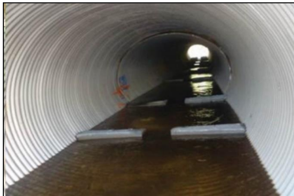
Figure 3.25 Chicanes du ponceau.
