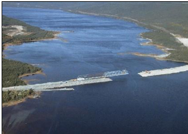
Figure 3.32 Vue aérienne du pont et du pont-jetée de la rivière Alexis construit le long de la route translabradorienne. Crédit photo : G. Jin et al. 2003.
