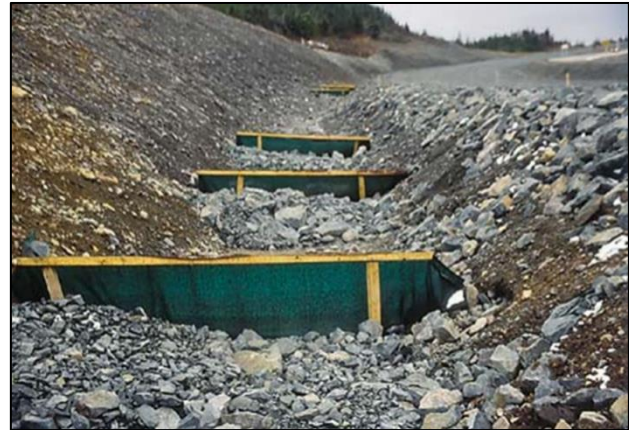
Figure 3.3 Barrages filtrants en tissu installés en série.
