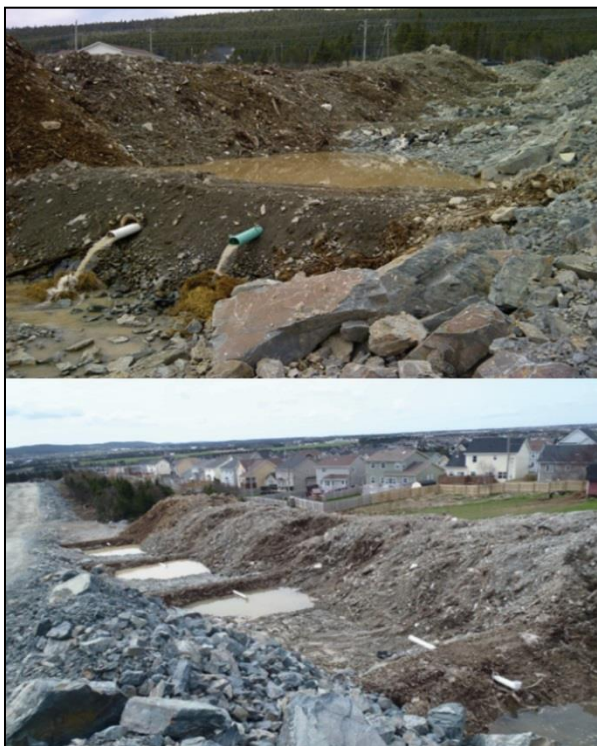
Figure 3.8 Vue d'une série de bassins de décantation (images du haut et du bas).
