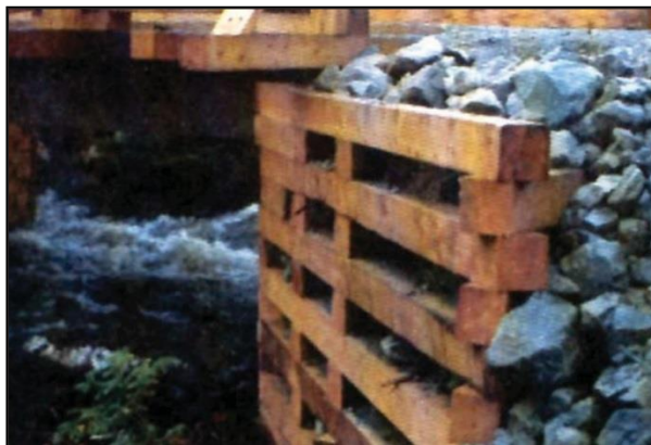
Figure 3.30 Les matériaux de remplissage des caissons de bois doivent être en blocs, angulaires et exempts de fines ou de sédiments.
