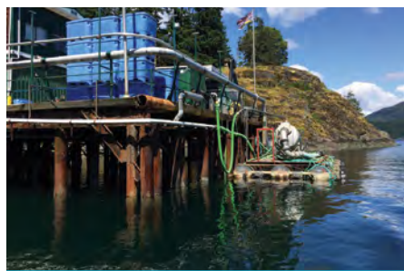
Usine de traitement de Brown's Bay. Photo : Stéphane Gauthier (MPO)
