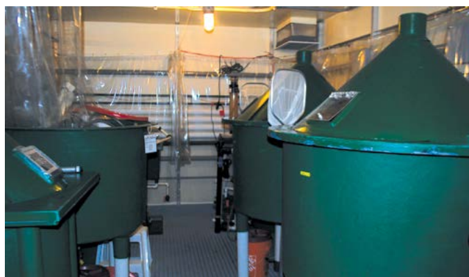
Installation de bioconfinement. Photo : Nellie Gagné (MPO)
